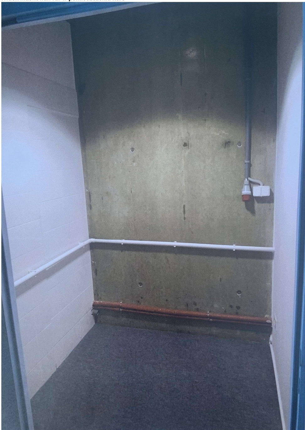
Widok maskowań rur w pomieszczeniu xero
